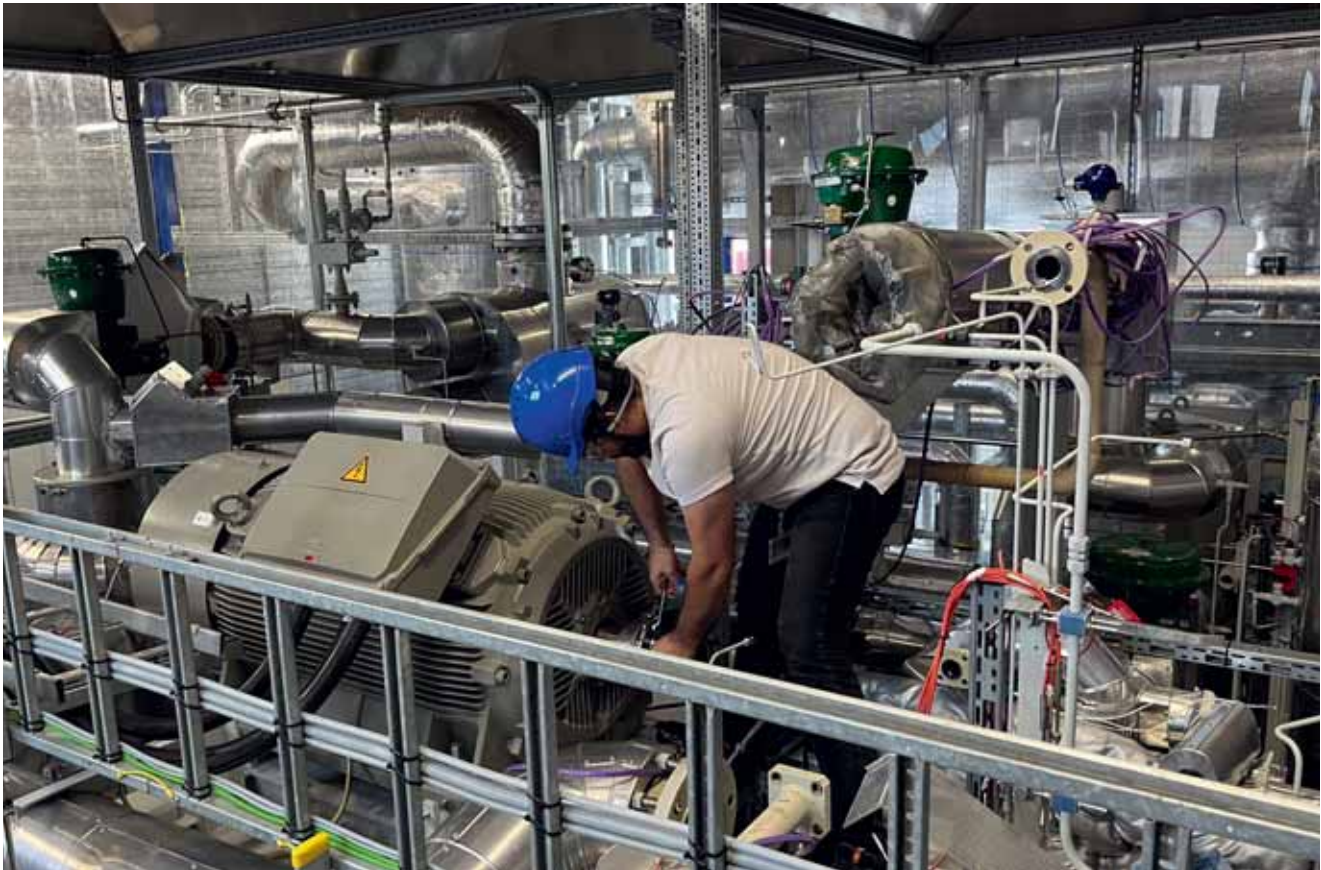
Installateur aan het werk met de demontage van een compressor in het lab van TNO.
